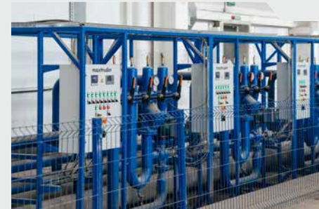
Installation de chauffage
